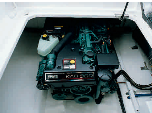
Rumpf und Motorraum Der Vorsteven schneidet die Welle, was dem Boot Rauwasserqualität gibt (oben). Servicearbeiten am Diesel lassen sich gut durchführen.
